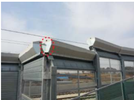
방음벽 상단에 설치된 소음저감장치
